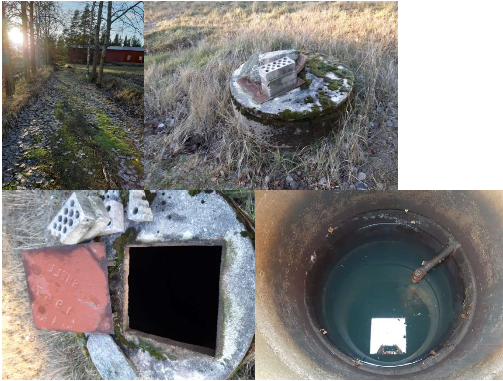
Kaivo 7. Veden fluoridipitoisuus ylittää sallitun.
